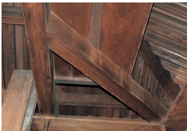
挿図7 隅行繫梁上部の破損と雨染み
