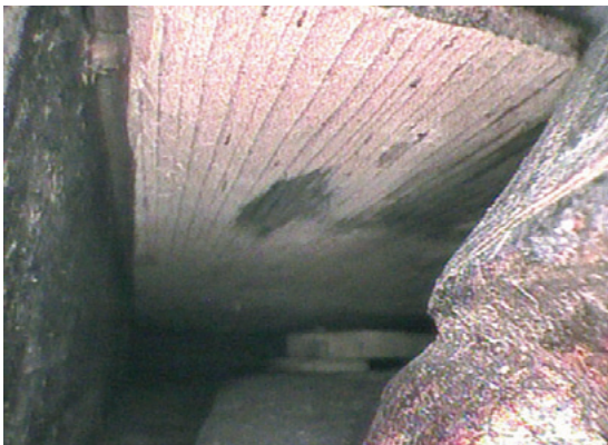
挿図7 同前 素地天板 水平樹脂道からヤニ様物質の滲み出し
